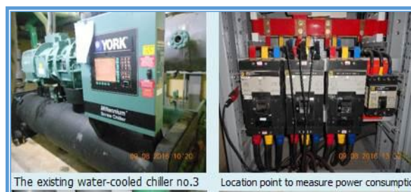
รูปที่ 1 เครื่องทำน้ำเย็น(Water cooled chiller)
